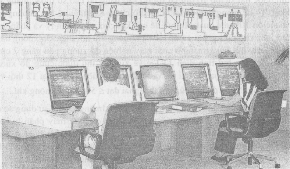
Hình 10. Phòng điều khiển trung tâm vận hành nhà máy xi măng
