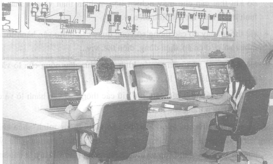
Hình 11. Phòng điều khiển trung tâm vận hành nhà máy xi măng.
