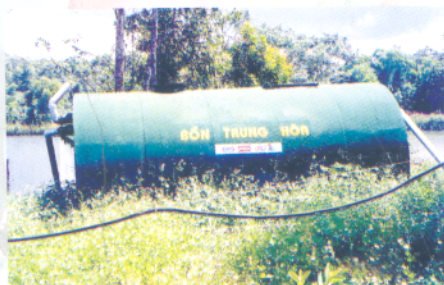
Bồn phản ứng trung hòa
