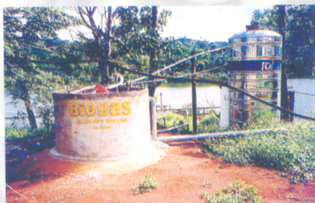
Bể chứa biogas
