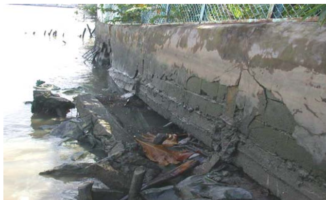
Hình 120. Tường kè bị nước bào xói phần chân
