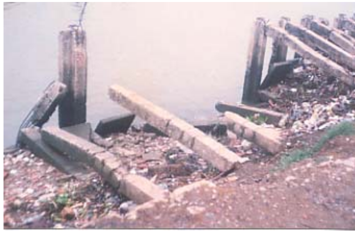
Hình 121: Khung bê tông cốt thép – kè Vĩnh Long cũ – Sông Tiền bị phá vỡ
