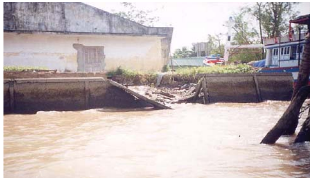
Hình 118. Tường cừ bê tông bảo vệ kho bên sông Tiền, tỉnh Tiền Giang bị phá vỡ
