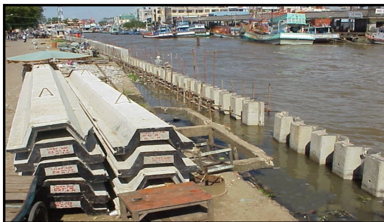
Hình 116. Công trình bảo vệ bờ bằng bản cọc bê tông ứng suất trước tại Kiên Giang
