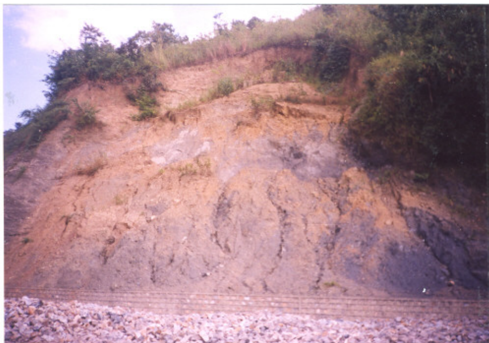
Ảnh 5: Trượt lở lớn taluy đường QL12 bản Háng Lì xã Huổi Lèng. Vỏ phong hoá độ dày lớn (30- 40m) phát triển trong trầm tích lục nguyên chứa than hệ tầng Lai Châu.
