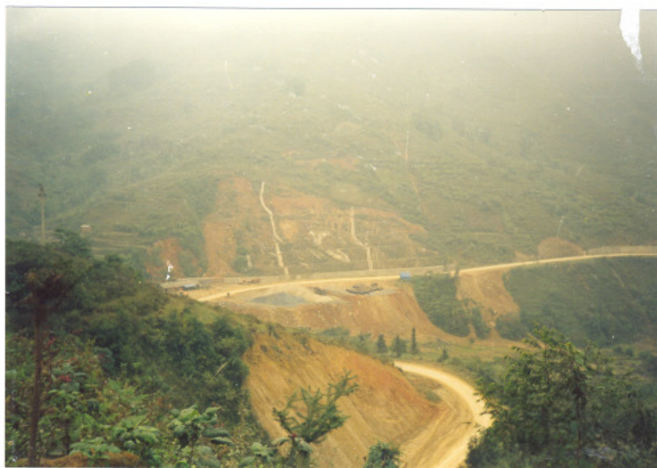
Ảnh 11: Kè taluy xử lý trượt lở ở phía bắc đầu cầu Móng Sến QL4D năm 2002 (Hệ thống bị hư hại do hoạt động tiếp tục của khối trượt).
