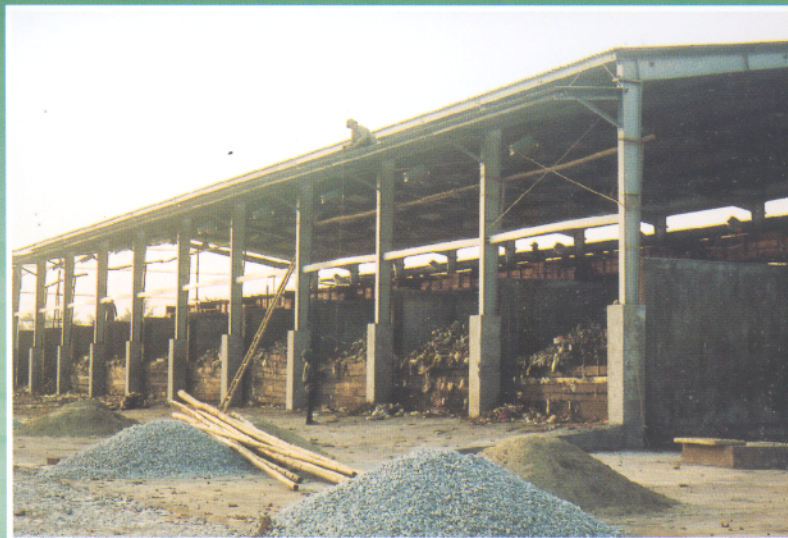
HỆ THỐNG BỂ Ủ RÁC
